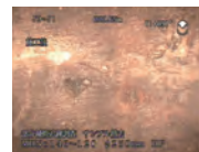
切り取り後 (クラック部に樹脂注入)
