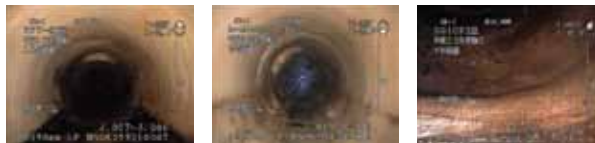
(経年10年) 一体型 異常なし (経年5年) 一体型 異常なし (経年5年) 一体型取付管側 異常なし
