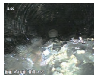
施工前状況 取付管 管底部(汚水が流れていた部分)の瀝青積層材の膨張 確認
