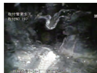
施工前状況 取付管 管頂部・管底部 瀝青積層材の膨張 確認
