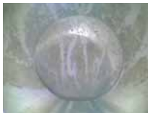
塩ビ管エルボー部分
