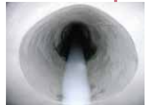
③ 管きょ型の型枠をはめ込み、無収縮モルタルにて管形成
