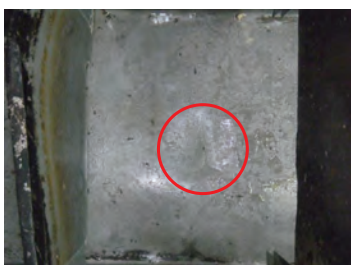
底部のひび割れ・凹み
