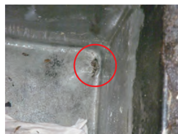
角の部分の破損・欠落
