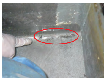
角の部分のクラック
