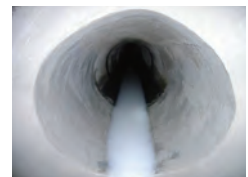
③管きよ型の型枠をはめ込み、無収縮モルタルにて管形成
